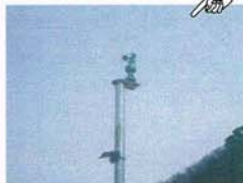
北校舎棟屋上に設置
