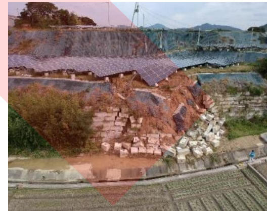
法面保護工が崩れて流出した事例
