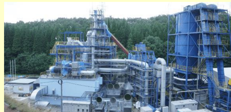
同社で稼働しているバイオマス発電プラント
